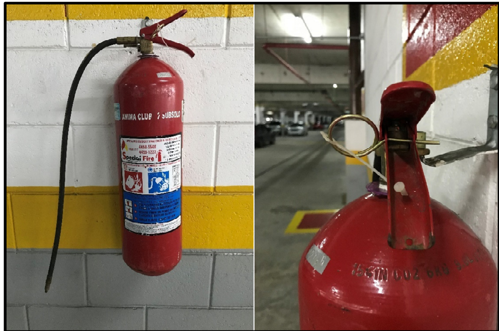
Figura 18 - Extintor com lacre rompido
