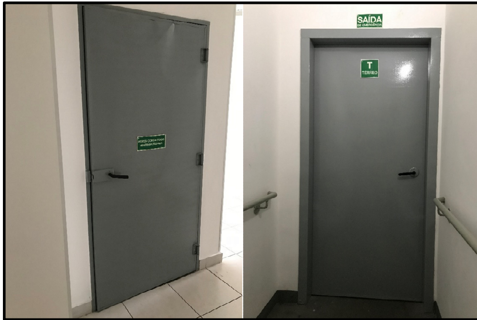
Figura 17 - Portas Corta Fogo
