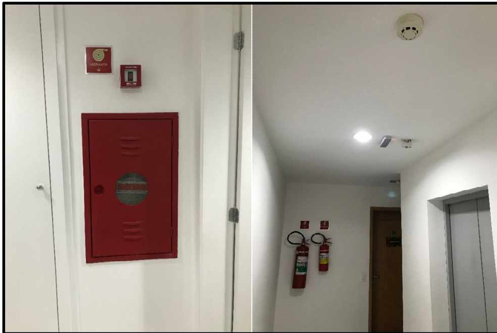
Figura 14 - Acionador manual de incêndio e detector de fumaça
