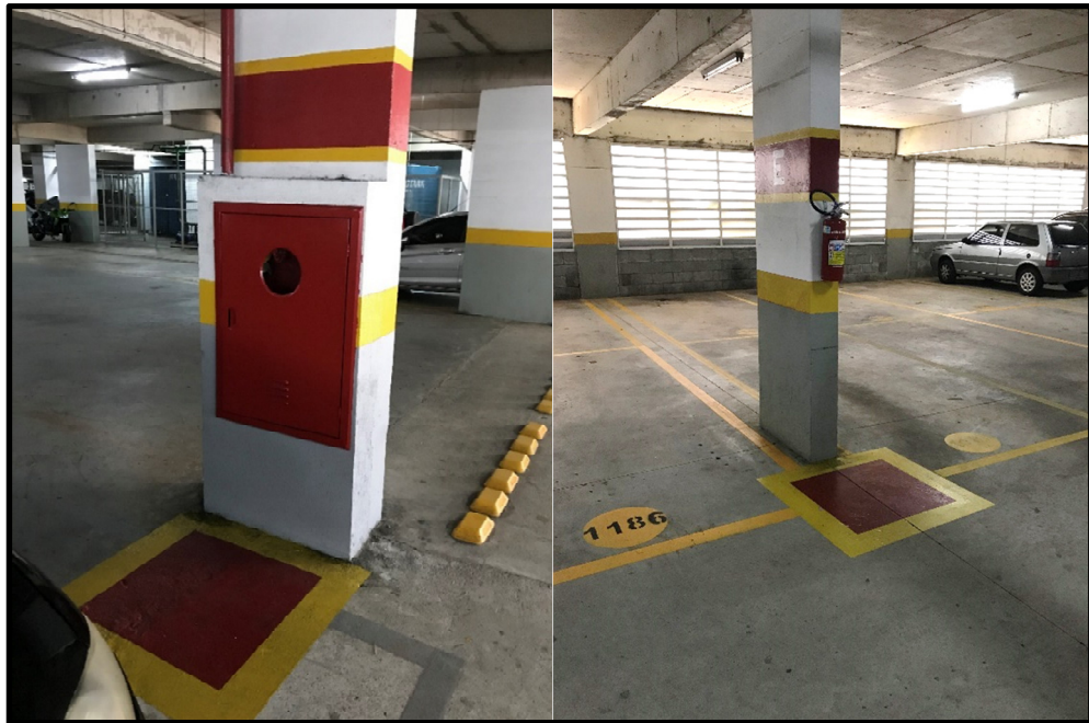
Figura 15 - Sinalização de emergência
