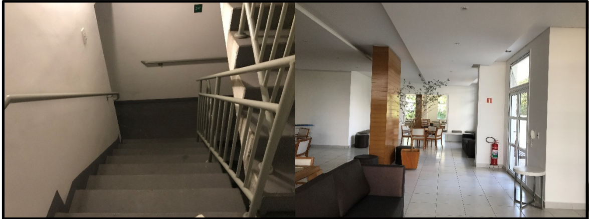
Figura 16 - Escada sem identificação complementar e extintor sem sinalização no piso
